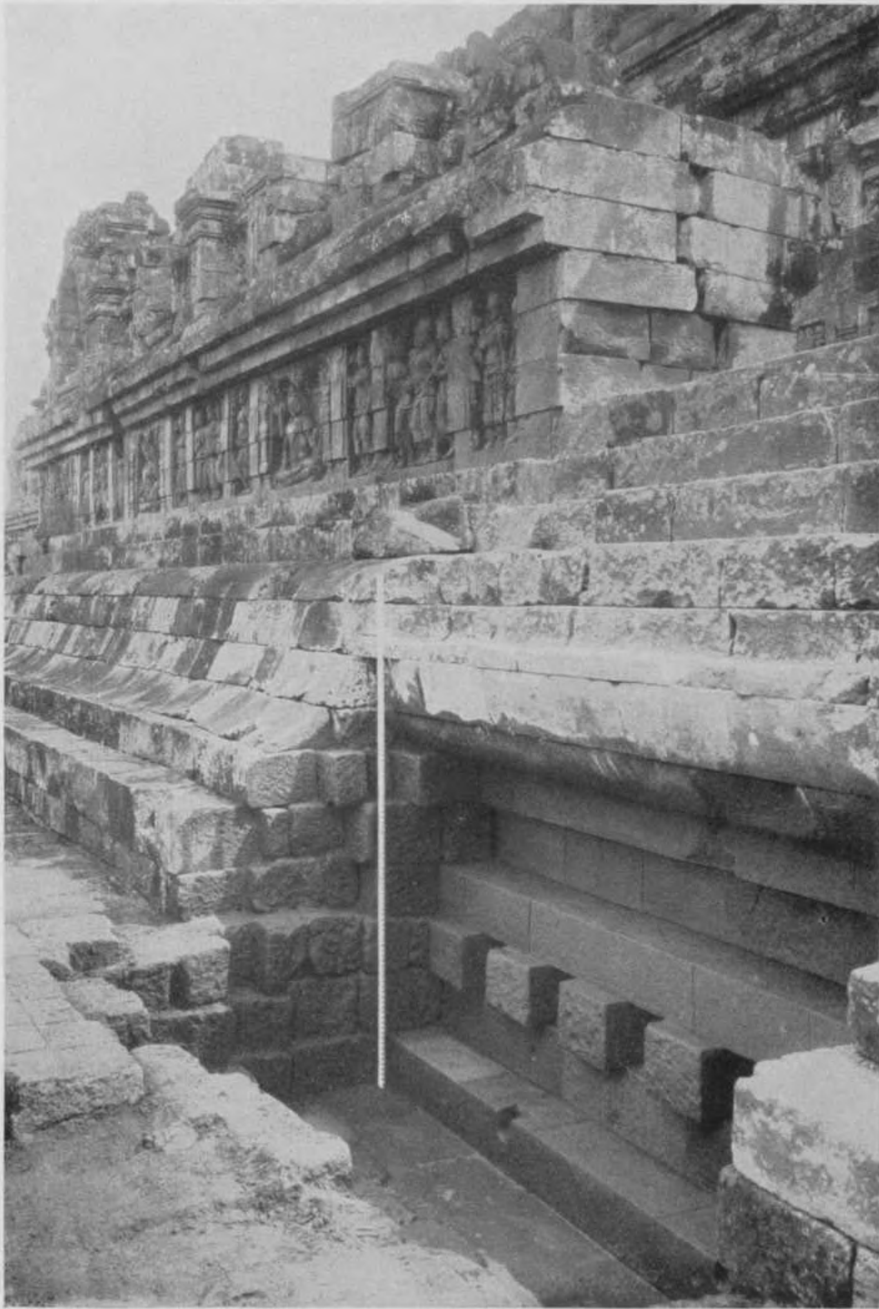
Breekgat ter plaatse van de Zuidelijke trap.
